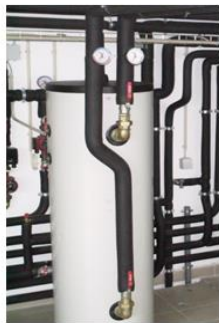
Exemplo de uma tubagem com isolamento
