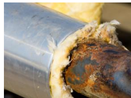
Exemplo de um isolamento danificado
