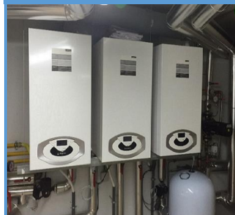
AQS (Águas Quentes Sanitárias)
