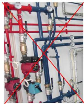
Exemplo de uma tubagem sem isolamento
