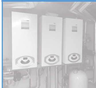
AQS (Águas Quentes Sanitárias)
