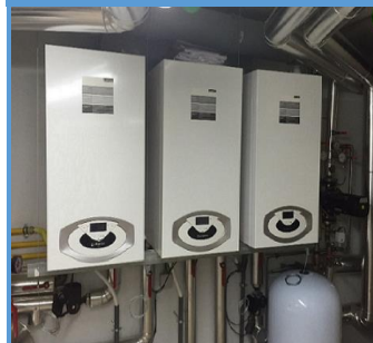
AQS (Águas Quentes Sanitárias)
